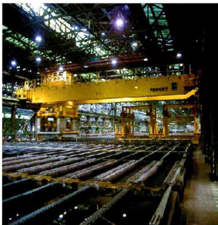
Figura 13. Puente Grúa Femont portando el "carro porta lingada" en el extremo izquierdo. En Vía de Transferencia se ubica el "tren de transferencia doble"
