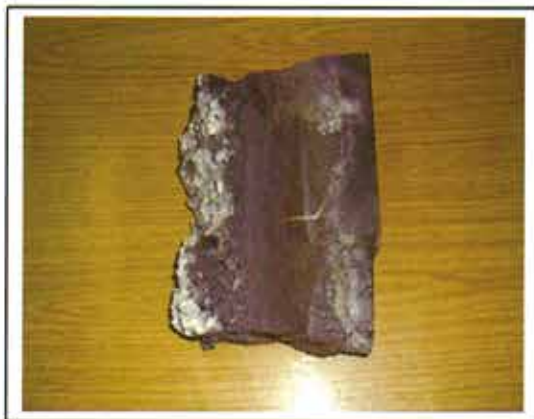
Fig. N°4: Muestra de un ladrillo desgastado.
