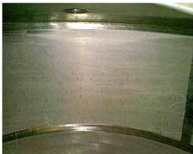
Figura 1.- Picaduras sobre la superficie interna de los tanques.
